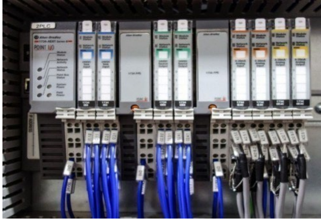
صورة ٨٦: وحدات تحكم منطقية قابلة للبرمجة
