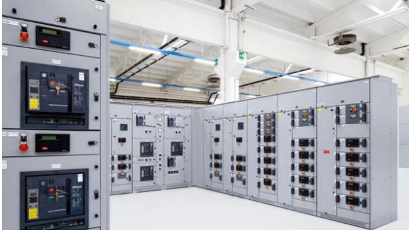
صورة ٨ مفاتيح الكهربائية
