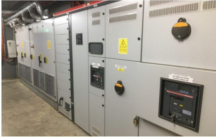
صورة ٢٠: المفاتيح الكهربائية
