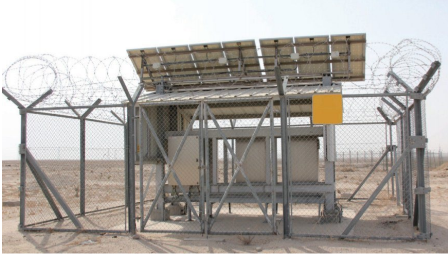
صورة ٨٥: كابينة وحدة التحكم الطرفية لمحطة الصمامات في الصحراء
