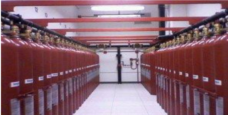
صورة ٤٦: أنظمة إخماد الحرائق باستخدام ثاني أكسيد الكربون
